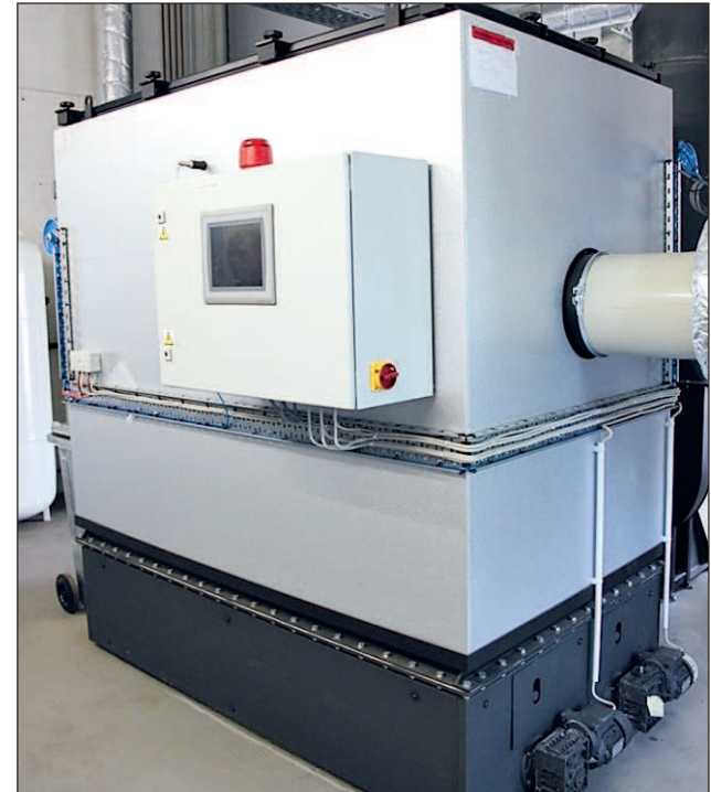
Das installierte Filtersystem basiert auf Keramikfilterelementen.
