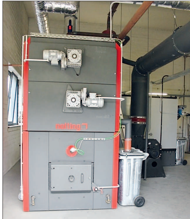
Unterschubfeuerung Typ „LCS-RU 520/600“ mit 600 kW Nennleistung
