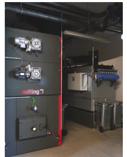
Nolting Holzfeuerung (600kW) mit Feinstaubfilter
