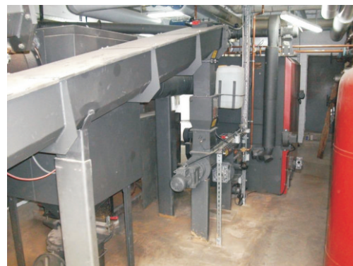
Brennstoffbeschickung und separater Staubabscheider (wärmeisoliert) mit Saugzug und leicht wechselbarer Staubtonne
