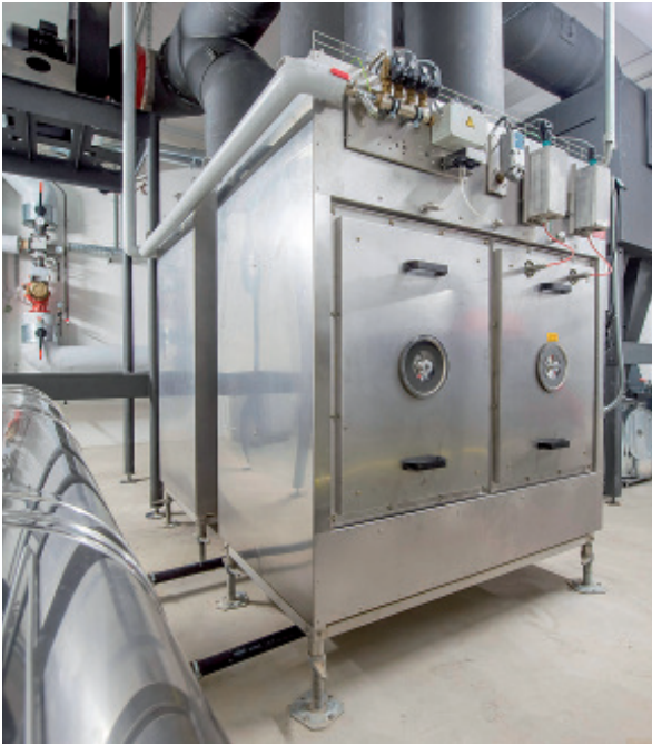
NOLTING trägt mit Feinstaubfiltern wie hier zur Nassreinigung dazu bei, dass die Staubemissionswerte eingehalten werden können.
