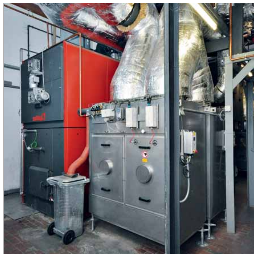
Zwei in Kaskade geschaltete Hackschnitzelkessel von Nolting sorgen für eine bedarfsgerechte Wärmeversorgung mit hoher Effizienz. Mit den in der Abgasstrecke nachgeschalteten Elektrofiltern (rechts) wird Feinstaub aus dem Rauchgas nahezu vollständig abgeschieden.
